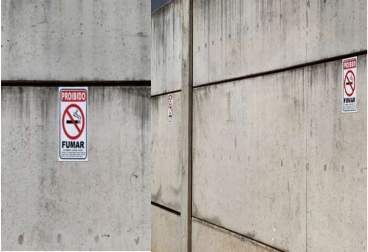
Figura 7 – Sinalização com placas de “proibido fumar”.
